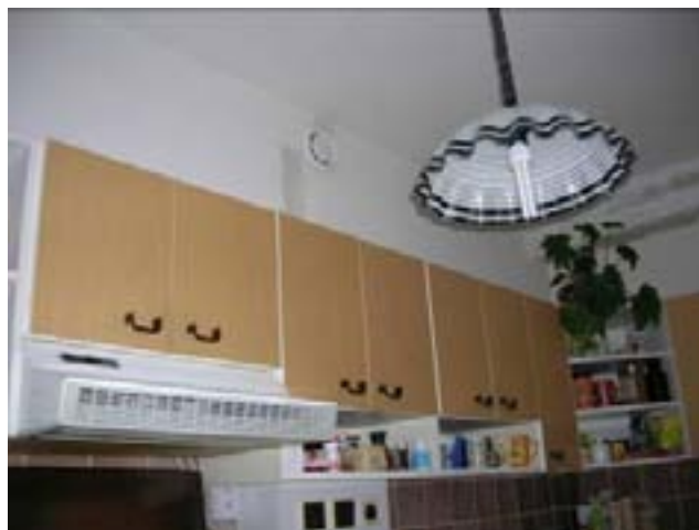
Odsávání vzduchu z prostoru kuchyně
