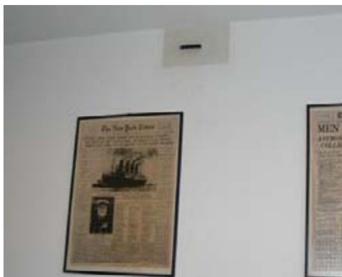
Přívod vzduchu do místností (dýza – štěrbin) – standard – před malbou stěn)
